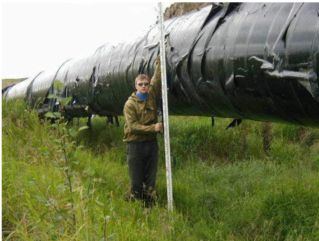
Рис. 1.9 Выпучивание подземного газопровод (фото В.В. Лашина)
