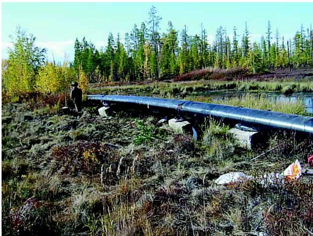
Рис. 1. Выталкивание подземного газопровода экзогенными процессами, несмотря на наличие пригрузов
