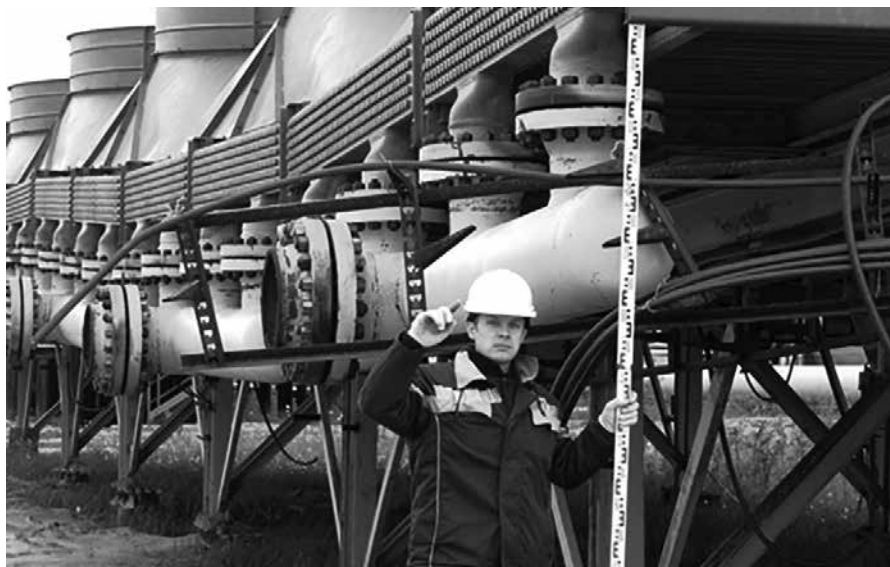
Рис. 4.4. Медвежье нефтегазоконденсатное месторождение. Деформации аппаратов воздушного охлаждения газа
