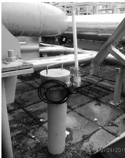
Рис. 4.11. Бованенковское нефтегазоконденсатное месторождение. Термометрическая наблюдательная скважина, оборудованная термометрическим оборудованием с функцией передачи сигнала по радиоканалу
