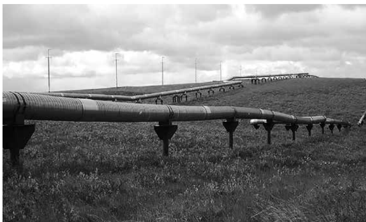
Рис. 8.22. Незатухающее выпучивание опор и деформация напорного нефтепровода Новый Порт—Мыс Каменный
