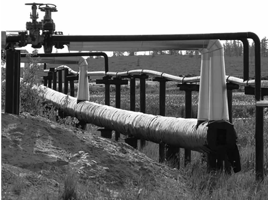
Рис. 4.3. Юбилейное нефтегазоконденсатное месторождение. Неравномерное выпучивание фундаментов трубопроводной обвязки куста газовых скважин
