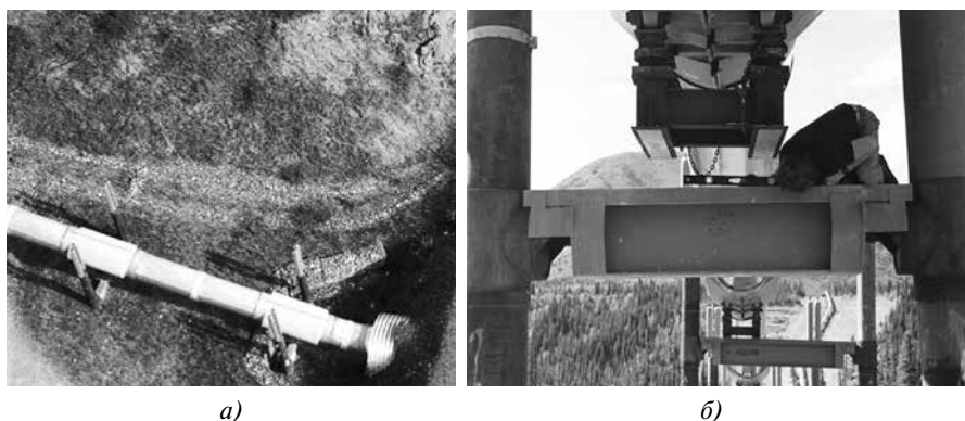
Рис. 4.1. Деформации на Трансаяскинском нефтепроводе, выявленные в процессе ГТМ. а — на участке развития криогенного оползания оттаивающих грунтов; б — на участке криогенного выпучивания опор
