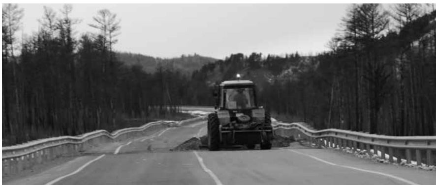
Рис. 4.26. Состояние автодороги «Амур» на одном из участков деградации вечной мерзлоты в ее основании, Забайкальская часть дороги, 19 октября 2014 г.
