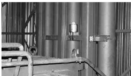
Рис. 8.12. Деформационные марки на КУ 1420 на КС «Байдарацкая»
