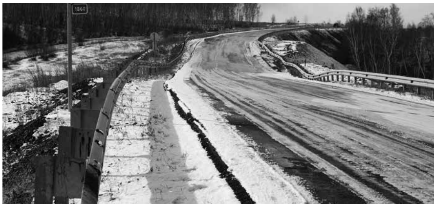
Рис. 4.30. Состояние автодороги «Амур» на переходе через руч. Чичон, 247 км, 19 октября 2014 г.
