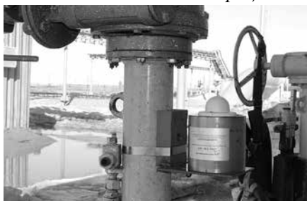
Рис. 8.13. Деформационные марки на КУ 159 на КС «Байдарацкая»
