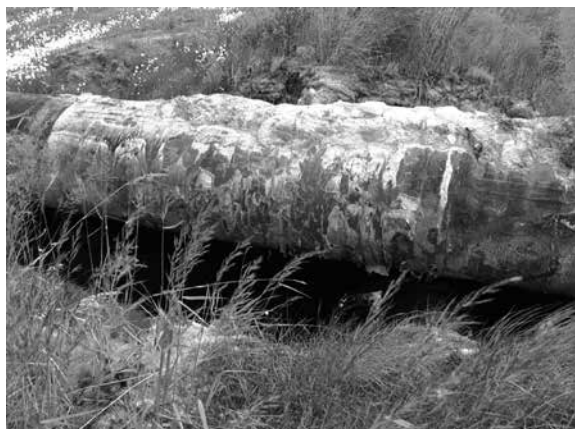
Б — выпучивание трубы газопровода вследствие неравномерного пучения
