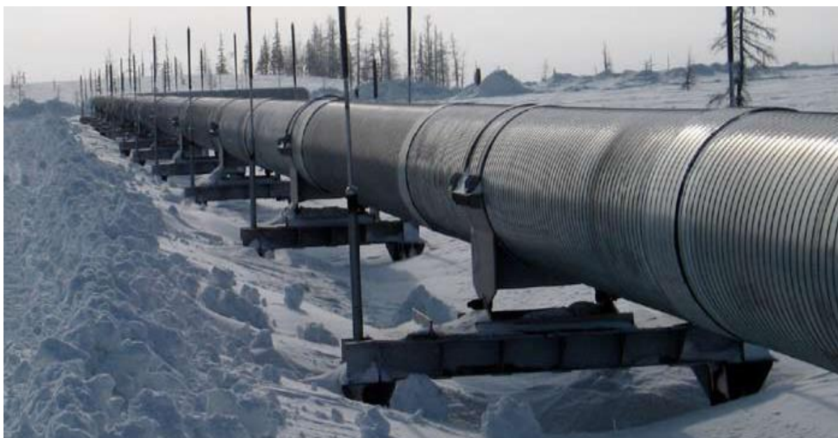
Рис. 1.11 Надземная прокладка нефтепровода Ванкор-Пурпе на низких опорах с термосифонами (фото С.Н. Окунева)
