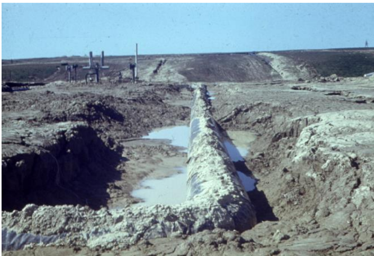
Рис. 1.8 Термоэрозионный размыв грунта на участке подземной прокладки трубопровода на территории газоконденсатного месторождения Медвежье (фото С.Ю. Пармузина)
