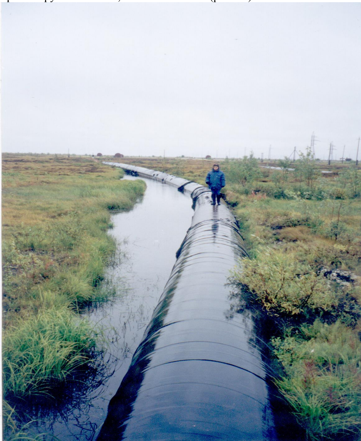
Рис. 1.7 Термокарст на горячем участке трассы газопровода Надым – Пунга. В результате оттаивания грунтов трубопровод, уложенный подземно, всплыл (фото А.Б. Осокина)
