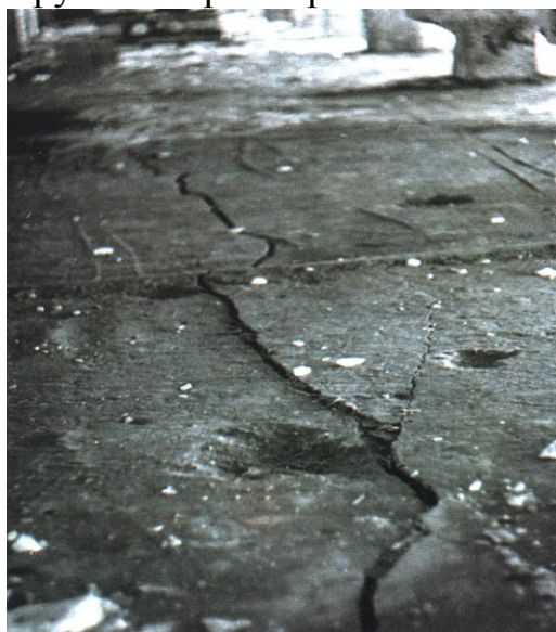
Рис. 1.6 Морозобойная трещина в основании крупнопанельного здания с вентилируемым подпольем в Якутске (фото Л.Т. Роман)
