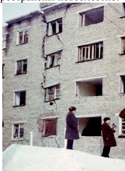
Рис. 1.1 Деформация жилого здания, построенного с использованием грунтов основания по принципу II (фото Е.М. Чувилина)
