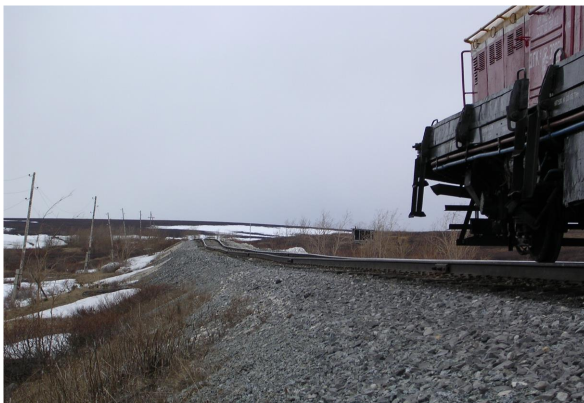
Рис. 1.13 Осадка земляного полотна на 58 км линии Чум – Лабитнанги в результате оттаивания многолетнемерзлых грунтов основании
