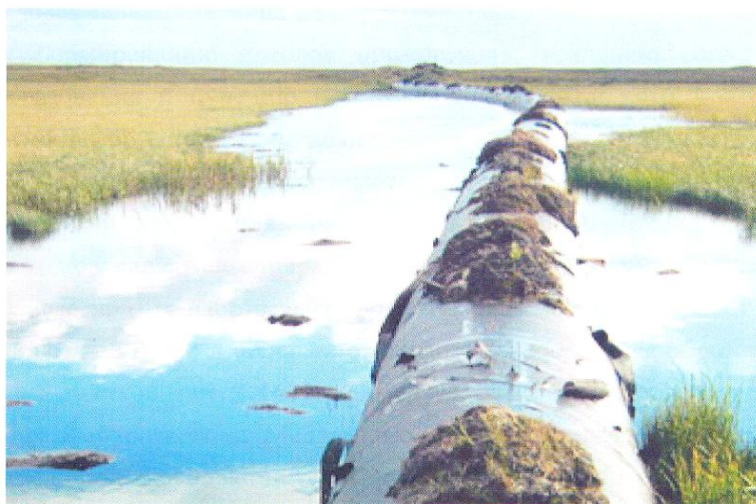
Рис. 5.22. Развитие термокарста на участке газопровода, фото В.В. Лашина [Грива, 2006].
