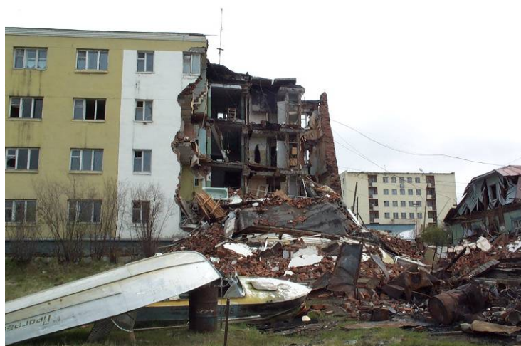
Рис. 14. Обрушившаяся в результате ослабления фундамента секция здания в поселке Черский. Фото В.Е. Романовского.
