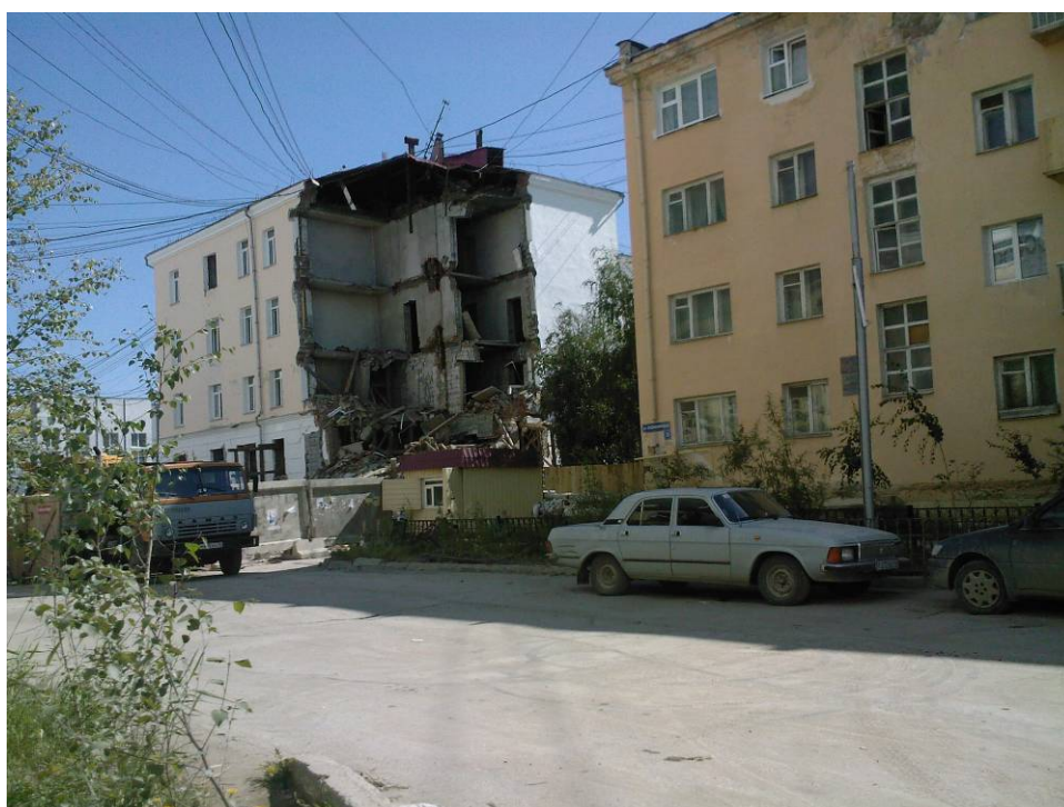
Рис. 13. Обрушение части здания Геологоразведочного управления в г. Якутске, 2009 г. (Фото М.Н. Григорьева)
